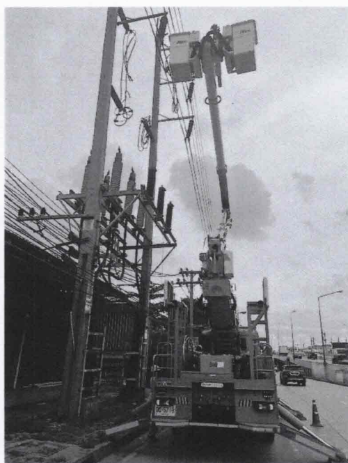
รูปที่ 2 เชื่อมสายลิตส์ 115 kv ที่ต้นเสา UG วงจร SAA 7YB-01 กลับสู่ระบบ
